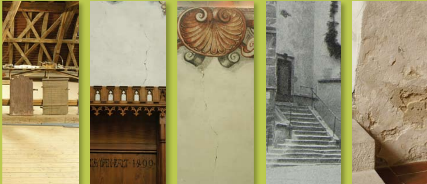
diverse Schäden an der Peterskirche
